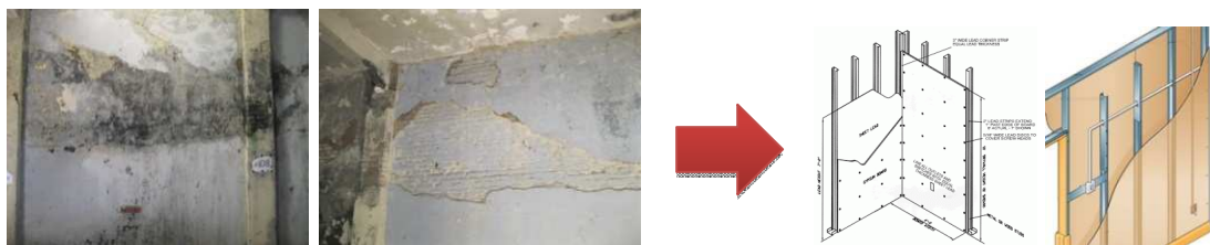
Gambar 10. Kerusakan Pada Dinding, Digunakan Kontruksi Dinding Baru (Wall Offset)
